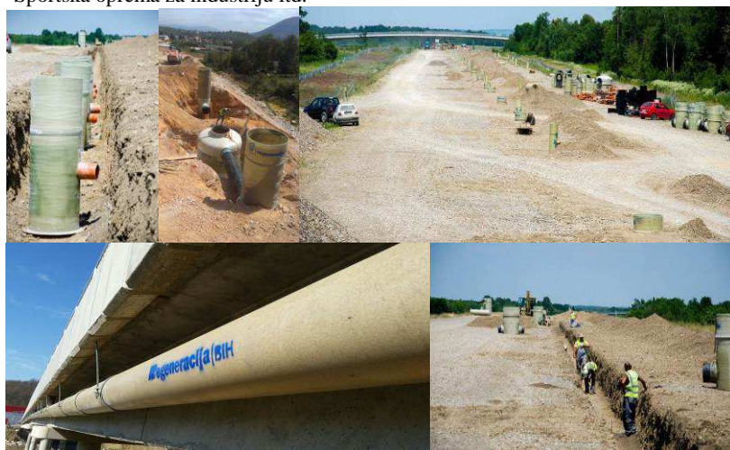
Slika 5: Primjena uređaja od armiranog poliestera kod sistema odvodnje autocesta [5]
