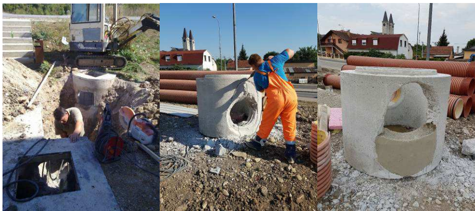
Slika 7: Betonska reviziona okna (naknadni priključak) [5]
