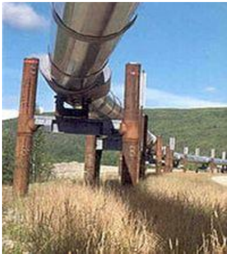
Slika 3.1. Naftovod na površini zemlje
